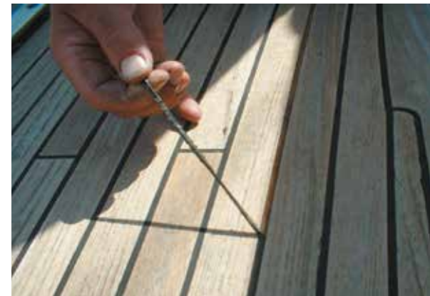
Abb. 46: Ausgeschnittene dreieckige Raupe des alten Fugenmaterials wird von Hand aus der Fuge gezogen
